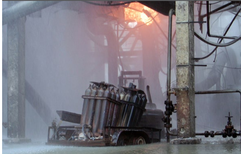
SOPORTE DE CAÑERÍA PROTEGIDA CON PYROCRETE RESISTE FUEGO DE HIDROCARBUROS.
